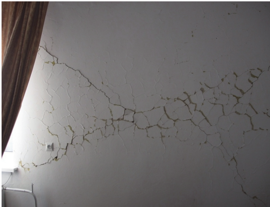
Fot. 5.4. Stopień V – krzyżowe pęknięcia ściany konstrukcyjnej widziane od wewnątrz budynku
