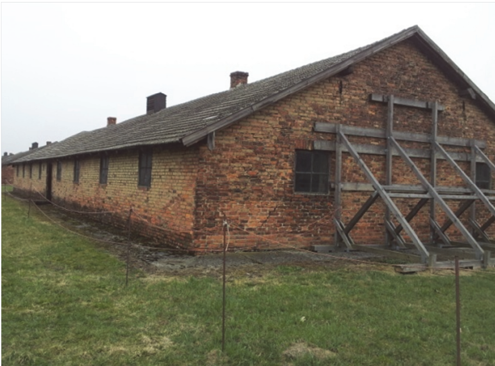
Fot. 6.22. Budynek muzealny wrażliwy na drgania i w złym stanie technicznym
