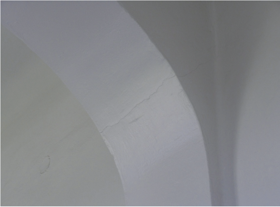
Fot. 5.15. Stopień II – zarysowanie tynku łuku ceglanego
