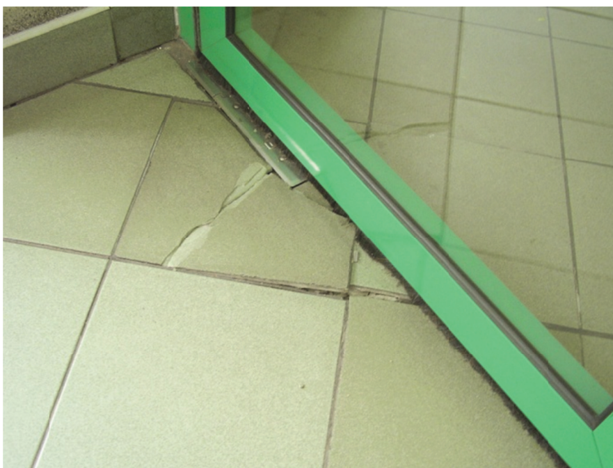
Fot. 5.12. Stopień III – odspojenie płytek
