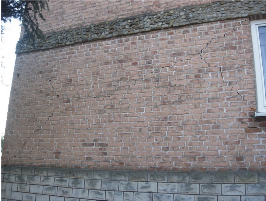
Fot. 5.3. Stopień V – krzyżowe pęknięcia ściany konstrukcyjnej widziane od zewnątrz budynku
