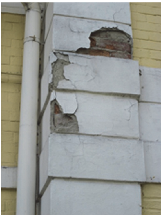
Fot. 5.11. Stopień III – odspojenie tynku muru zewnętrznego – Doubrava (Czechy)
