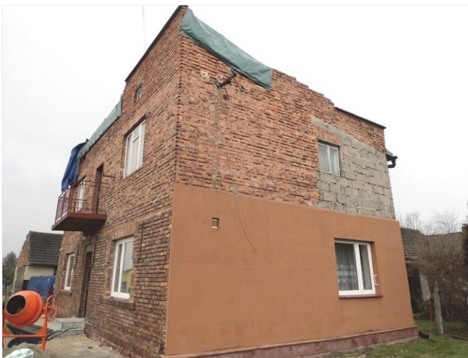
Fot. 5.1. Stopień V – przemieszczenie konstrukcji dachu, zniszczenie dużych fragmentów ścianek kolankowych
