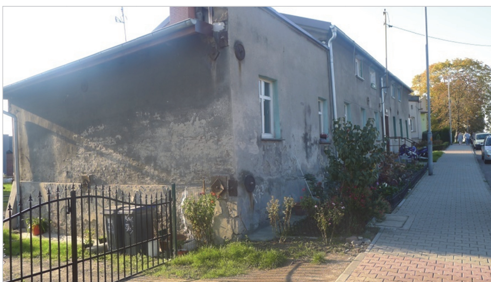
Fot. 6.24. Budynek mieszkalny wybudowany w technologii tradycyjnej poddany wpływom deformacji ciągłych i kotwiony
