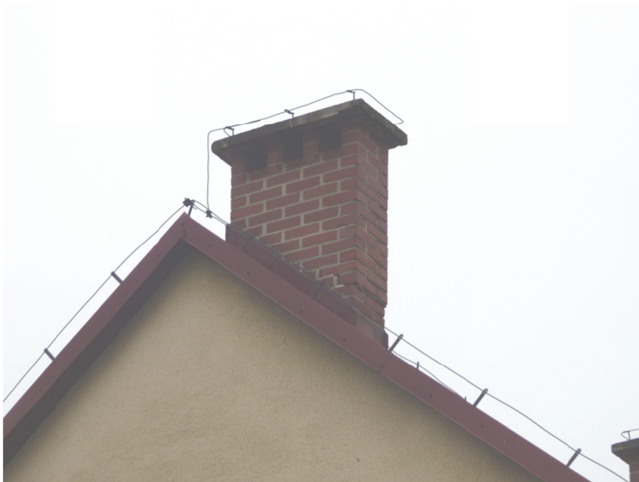
Fot. 5.7. Stopień IV – pęknięcie i przesunięcie muru komina ceglanego nad dachem
