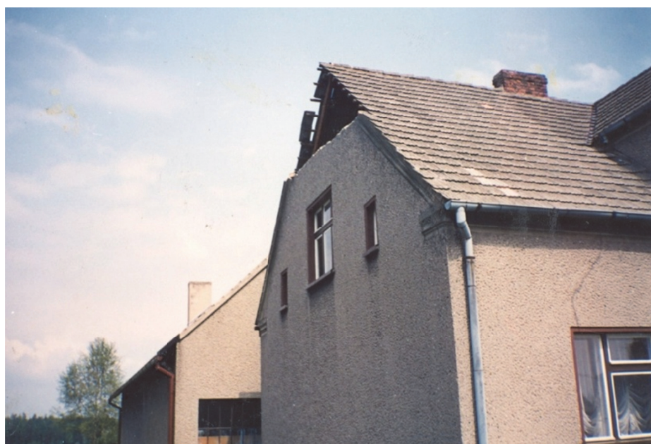
Fot. 5.2. Stopień V – zawalenie się fragmentu słabo zamocowanej ściany szczytowej i pęknięcie nadproża ściany nośnej
