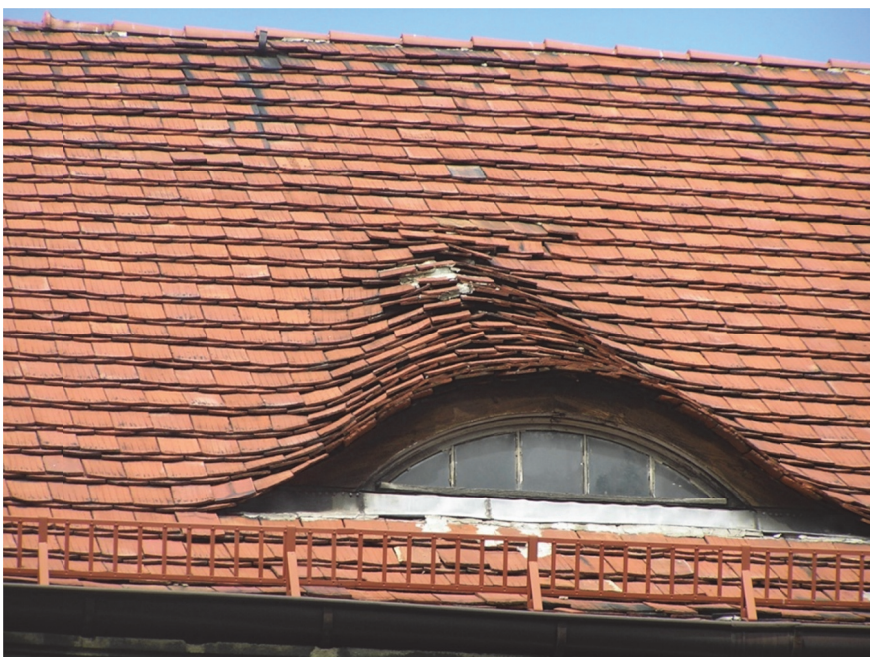
Fot. 5.9. Stopień III – duże rozluźnienia i uszkodzenia dachówek w rejonie okna dachowego
