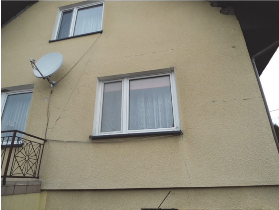
Fot. 5.5. Stopień V – krzyżowe pęknięcie filara międzyokiennego
