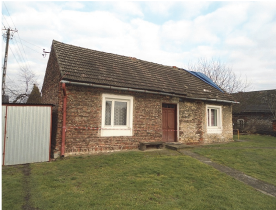
Fot. 5.6. Stopień V – ścięcie dwóch kominów ceglanych, załamanie fragmentu dachu przy rynnie, uszkodzenia pokrycia dachowego
