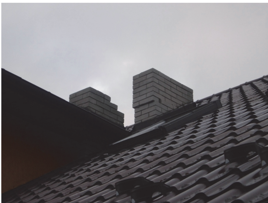
Fot. 5.10. Stopień III – ścięcie spoiny muru komina z przemieszczeniem jego górnej części i ubytki cegieł z drugiego komina
