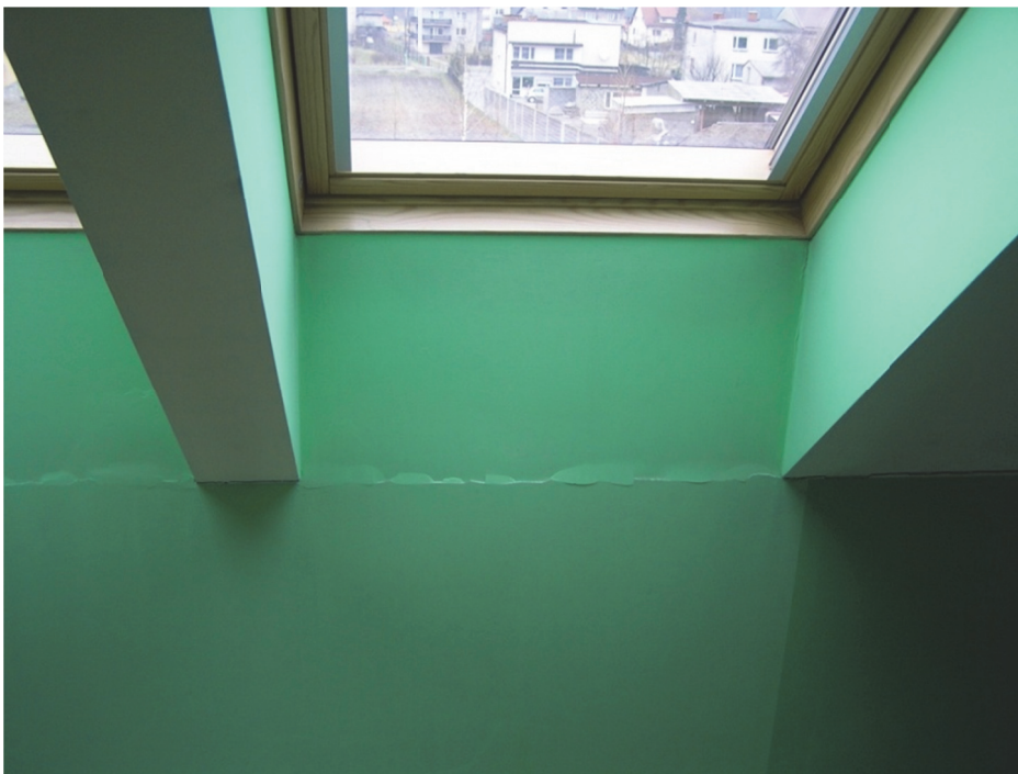
Fot. 5.14. Stopień II – pęknięcia i odspojenia gładzi na styku płyt gipsowo-kartonowych
