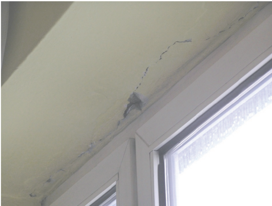
Fot. 5.13. Stopień III – uszkodzenia tynku wokół ościeżnicy okna
