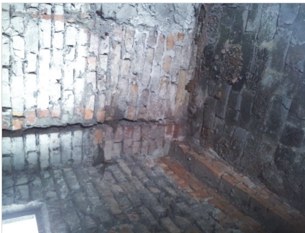
Fot. 6.23. Budynek muzealny wrażliwy na drgania i w złym stanie technicznym
