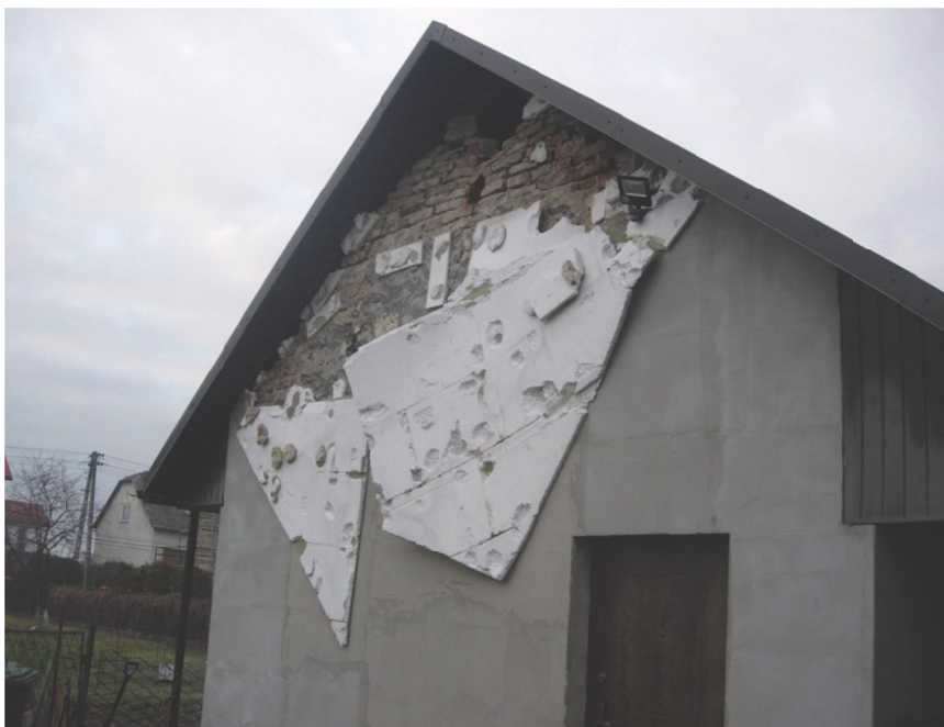
Fot. 5.8. Stopień III – zerwanie warstwy ocieplającej ściany szczytowej budynku gospodarczego
